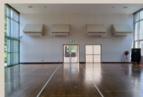
プレイルームに設置されたエアコン (竹園西児童館プレイルーム)
