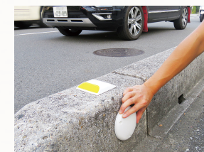
車道縁石に冠水センサーを設置し内水発生時にすぐ対応
